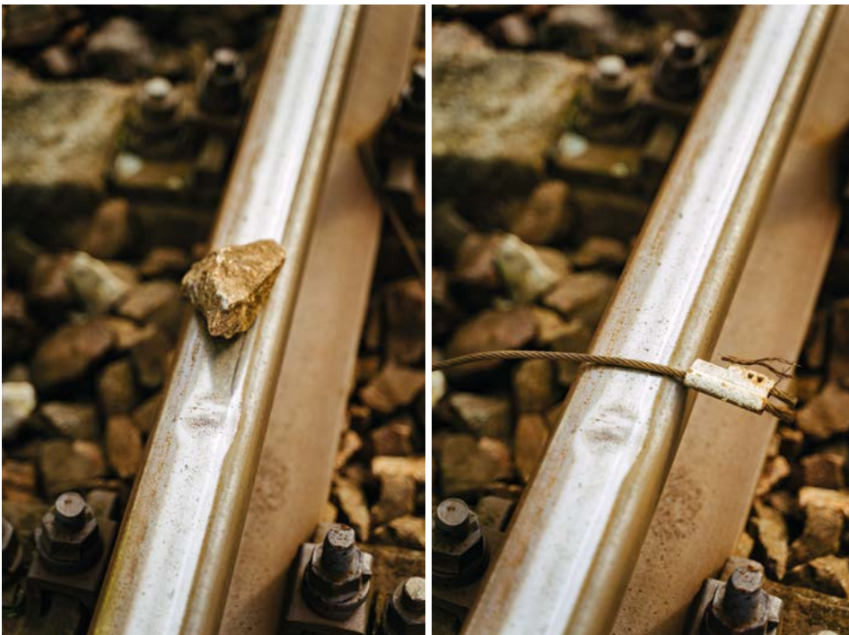
Pilt 71 Kivid ja muud esemed, mis tekitavad rööpale defekteid
